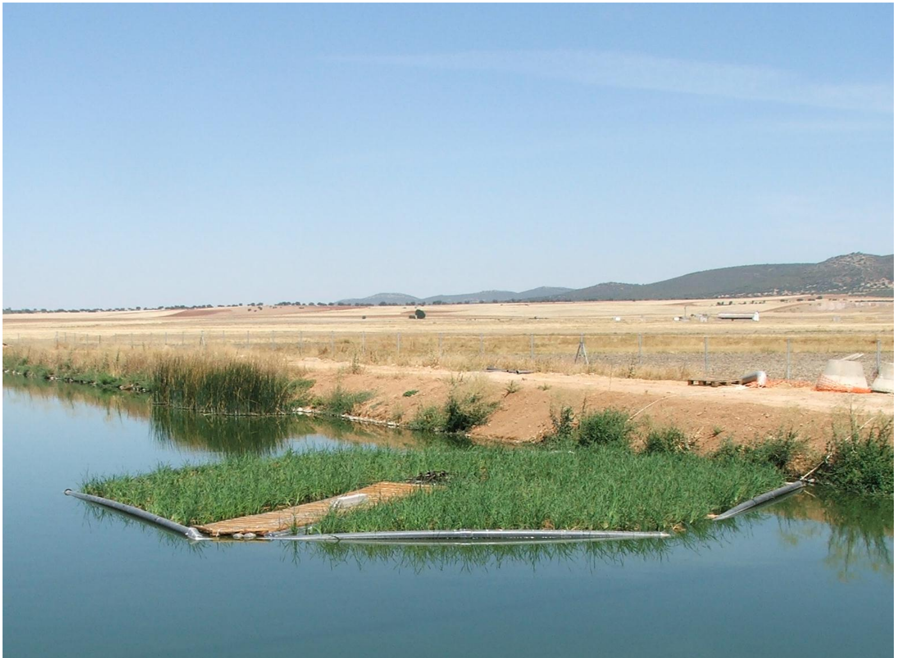
EDAR Isla Flotante Hidrolution FMF, en Villamayor (Ciudad Real)
